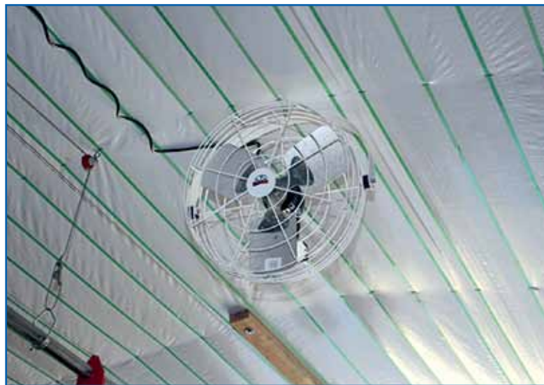
Фото 1. Вентилятори-повітрерозгінники покращують мікроклімат у пташнику
